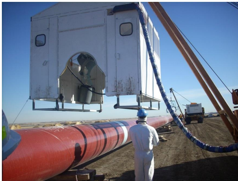
Cabine d'application de revêtements sur les soudures circulaires
